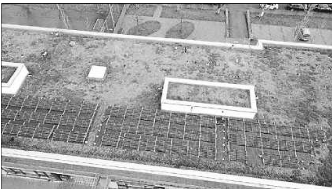
Installierte PV-Module auf dem Dach des Kinderhauses Hutwiesen
