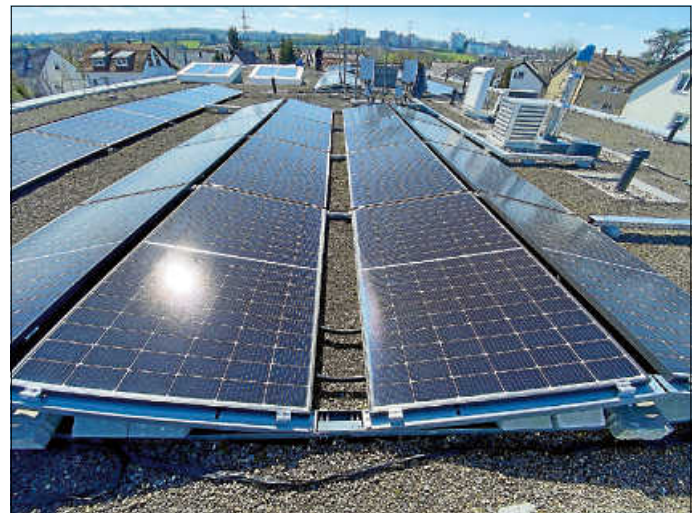
Installierte PV-Module auf dem Dach des Kindergartens Grafenbühl
