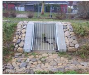
Verwallung und Einlaufbauwerk
